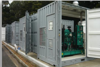
Подстанция/ генераторная Помещение для генератора и электростанций
